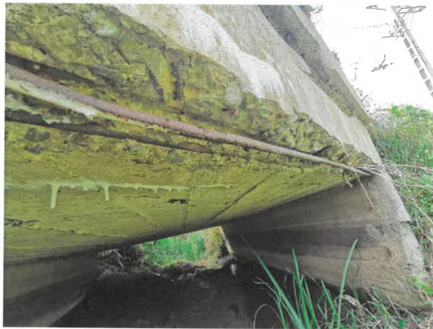
Fig. 4 – Degradare beton si armaturi expuse ruginite
