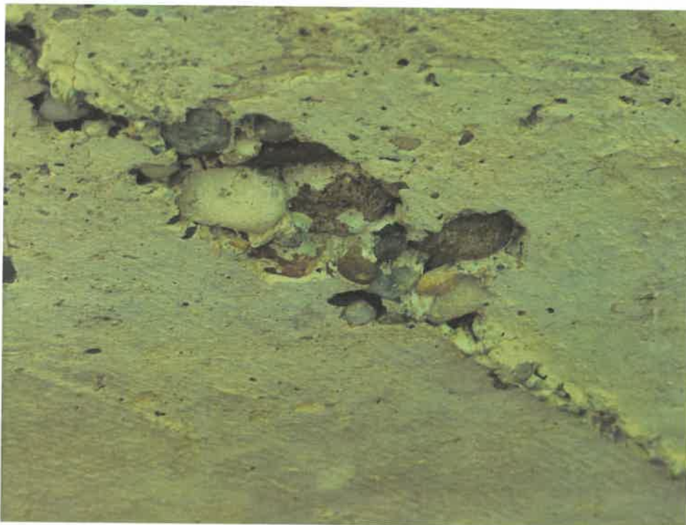
Fig.8 – Exfolieri ale betonului la intrados
