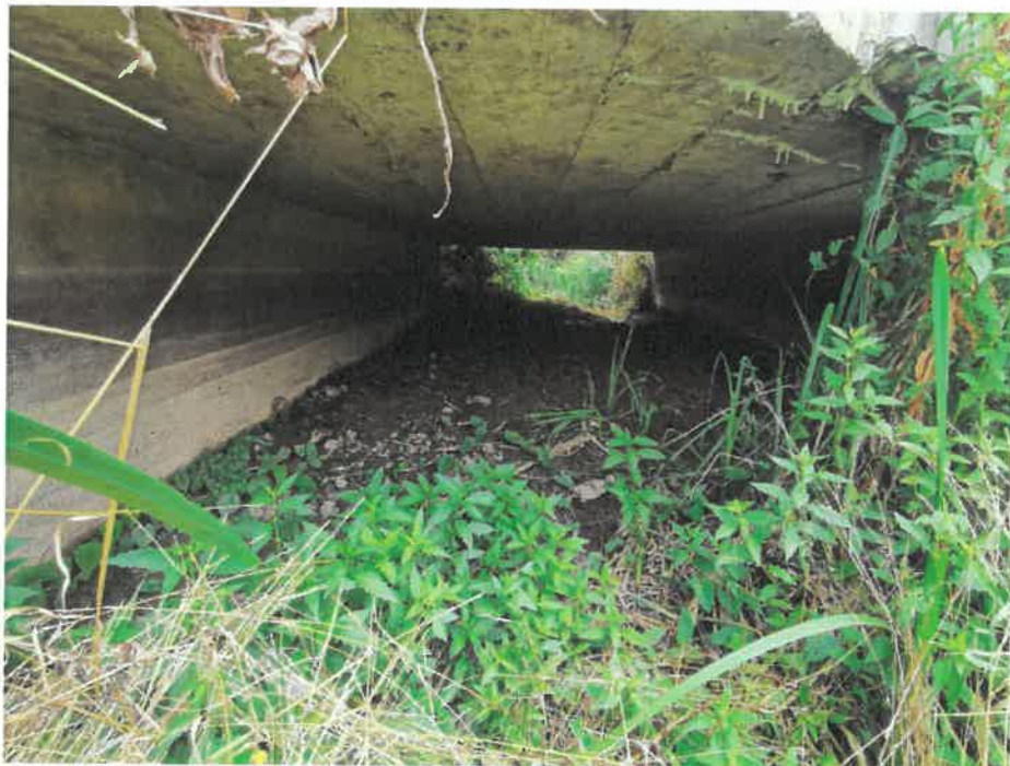
Fig. 2 - Vedere sub podeș spre amonte. Albia este colmatată cu aluviuni si vegetație
