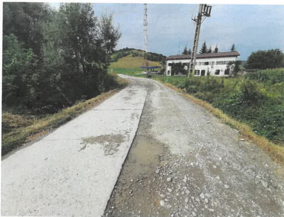
Fig. 5 – Suprastructura podet degradata
