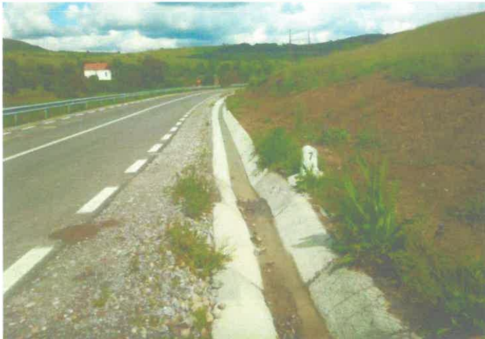
Fig. 9 Situația existentă a sectorului de drum la momentul vizitei în teren, pe fiecare zonă delimitată, funcție de problemele identificate - 2020
