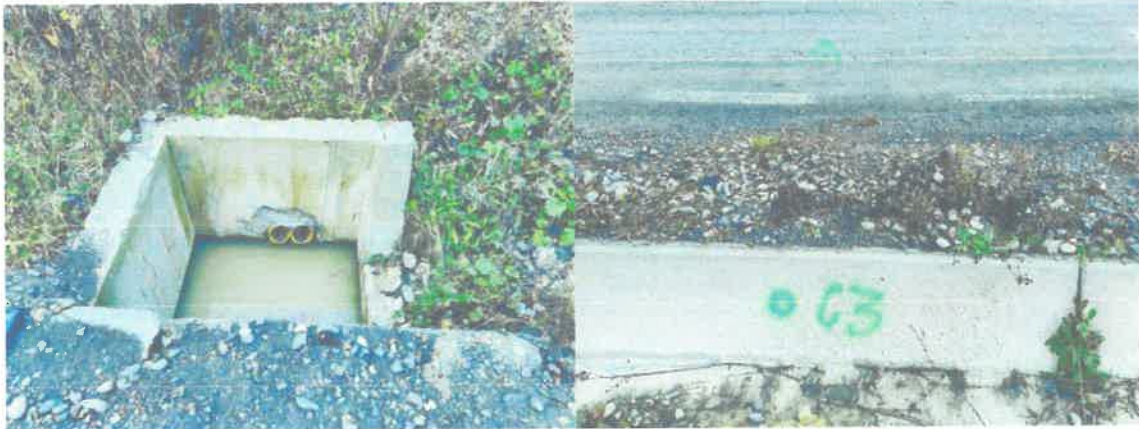
Fig. 11 Situația existentă a sectorului de drum la momentul vizitei în teren, pe zona delimitată - 2021
