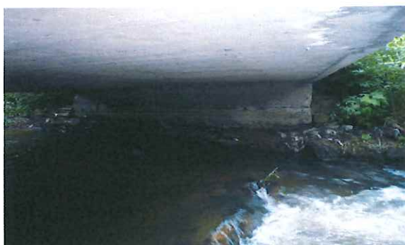
Foto nr. 9: Vedere culee mal stang. Eroziuni pe fata vazuta a culeei. Infiltratii la intradosul dalei structurii de rezistenta. Vedere in aval unde exista un prag de fund inecat, amplasat incorect si degradat.
