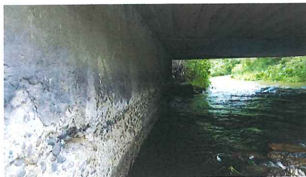
Foto nr. 10: Detaliu erodari ale fetei vazute a culeei. Agregate care nu sant inglobate in pasta de ciment. Lipsa material. Intradosul dalei prezinta urmele de la decofrare.
