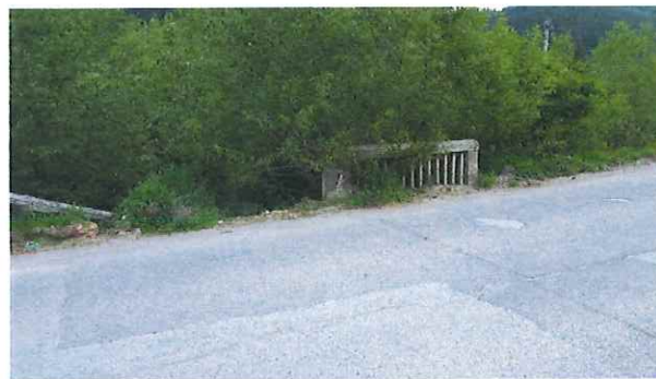
Foto nr. 4: Parapetul pietonal este in totalitate degradat. Partea carosabila este degradata, prezinta gropi, faiantari si fisuri.
