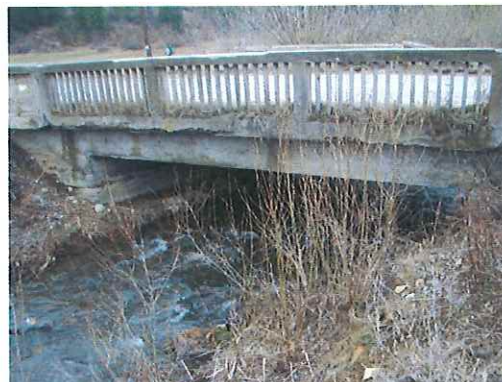
Foto nr.2: Vedere laterala. Grinda de parapet degradata. Vegetatie pe grinda de parapet. Degradari ale elevatiei culeei mal drept.
