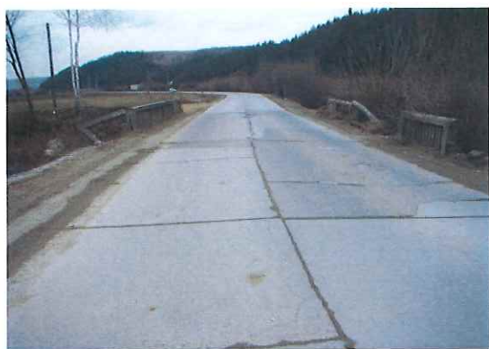
Foto nr. 1: Vedere spre Balan. Parte carosabila cu fisuri, gauri si material derapant.
