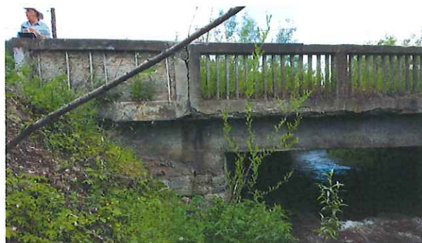
Foto nr. 8: Vedere in detaliu a degradarilor la racordarile cu terasamentele. Infiltratii, vegetatie pe sferturile de con. Tencuiala degaradata.
