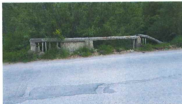
Foto nr. 6: Parapetul pietonal distrus in totalitate, pe pod si pe zona racordarilor cu terasamentele. Parte carosabila degradata si reparata relativ recent.
