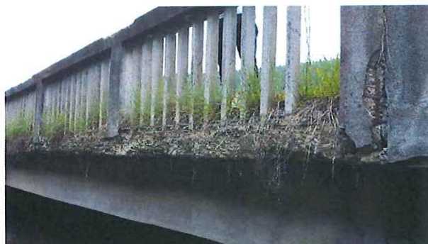
Foto nr. 7: Parapet degradat. Grinda de parapet distrusa, armatura la vedere, vegetatie pe partea carosabila.
