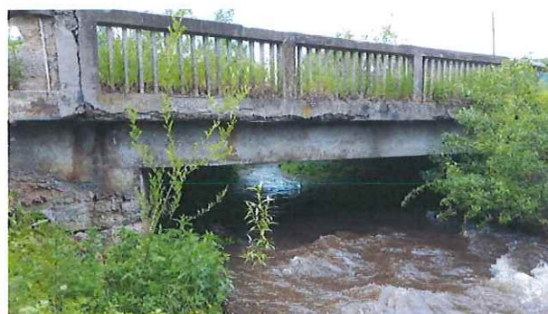
Foto nr. 3: Vedere din aval: grinda de parapet degradata. Zidul intors prezinta o tencuiala degradata. Se vad moloanele si rosturile dintre ele.
