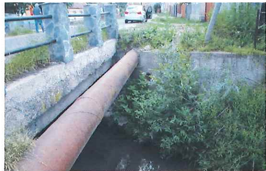
Foto nr. 6: Vedere din amonte. Conducta de apa in imediata vecinatate a dalei si grinzii de parapet. Grinda de parapet netencuita. Vegetatie langa grinda de parapet
