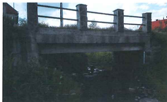
Foto nr.2: Vedere din amonte spre aval. Grinda de parapet degradata. Beton segregat
