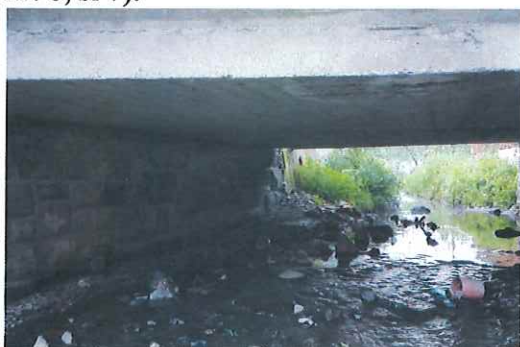
Foto nr. 3: Culee mal drept. Fata vazuta din zidarie de moloane. Sub pod albia este colmatata. Intradosul dalei prezinta armaturi la vedere si zona cu beton exfoliat.
