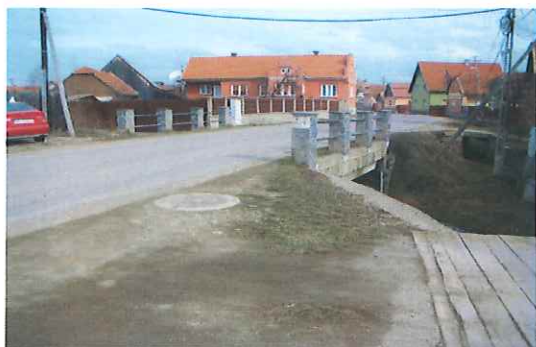
Foto nr. 1: Vedere generala. Podul nu are parapete directionale, nici trotuare
