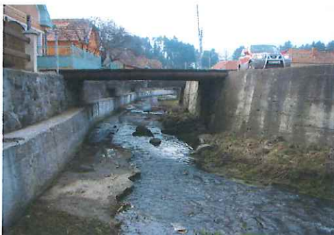
Foto nr.9 : Vedere spre aval. Amenajarea albiei in zona aval. Malul drept este indiguit cu un zid de sprijin, din zidarie de piatra cu mortar de ciment, care a fost camasuit ulterior.
