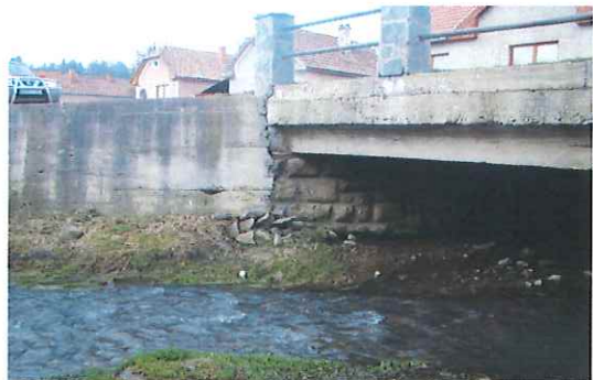
Foto nr. 8: Culee mal stang-aval. degradari, subspalari la fundatie. Zidul de racord, si de amenajare albie prezinta zone cu material lipsa.
