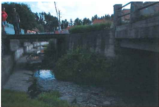
Foto nr. 5: Vedere aval. Vegetatie langa zidul intors mal drept. Erodari si afuieri ale zidului de protectie mal drept aval
