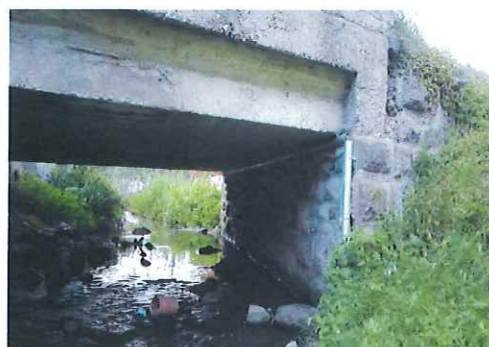
Foto nr. 4: Vedere din aval. Sfertul de con degradat in totalitate. Vegetatie pe zidul intors si pe taluz depuneri de material solid
