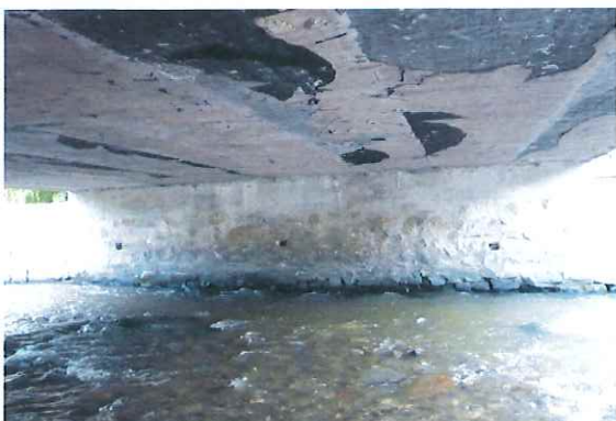
Foto nr. 3: Vedere intrados dala. Tencuiala este exfoliata si se vad urme de hidroizolatie. Degradari ale elevatiei la rostul de contact cu suprafata apei.
