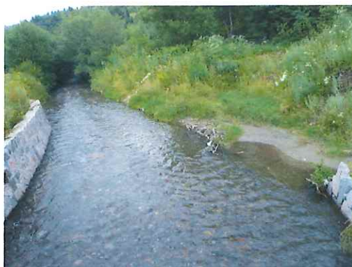
Foto nr. 9: Vedere albie spre aval. se continua lucrarile pentru amenajarea si protectia malului drept aval.
