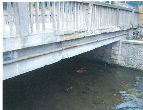
Foto nr. 10: Vedere din amonte. Conducta incastrata in zidurile de racordare cu terasamentele. Degradari ale grinzii de parapet si ale parapetului.
