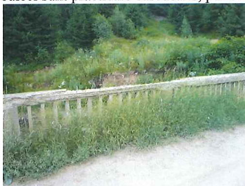
Foto nr. 7: Vedere degradari ale parapetului pietonal. Trotuarul nu este vizibil din cauza straturilor suplimentare de asfalt turnate pe partea carosabila si a vegetatiei aparute.
