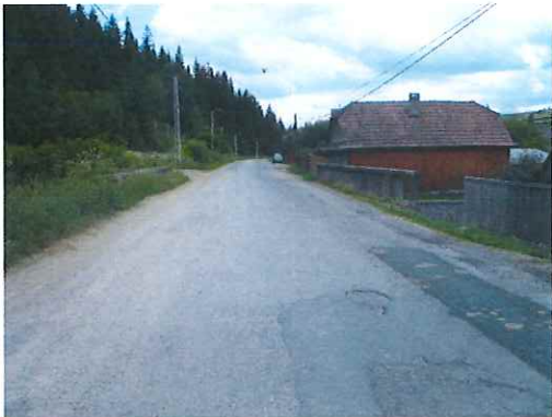
Foto nr. 1: Vedere generala. Parte carosabila cu gauri, cu reparatii recente, cu vegetatie pe spatiile de siguranta.
