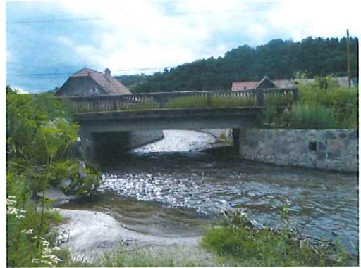
Foto nr.2: Vedere din aval. In sectiunea podului albia are un o forma sinusoidala. Malul stang aval este regularizat cu zid de sprijin din zidarie cu moloane de piatra
