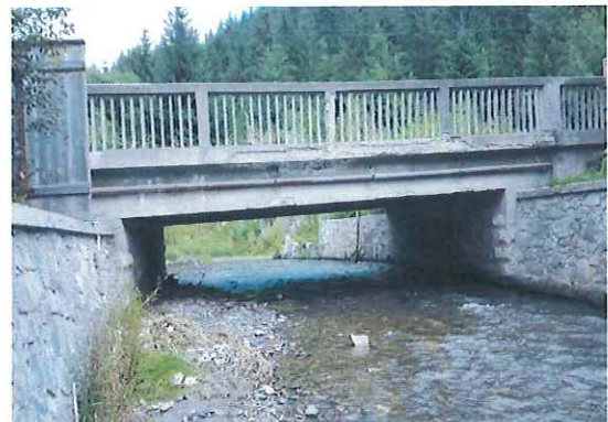
Foto nr. 4: Vedere din amonte. Conducta incastrata in zidurile intoarse. Grinda de parapet degradata. Parapetul pietonal-degradat.
