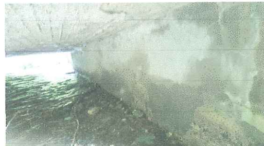
Foto nr. 4: Vedere intrados dala si culee mal stang. Degradari ale fetei vazute a elevatiei. Tencuiala este umectata, fisurata. Beton segregat la rostul elevatie-fundatie.
