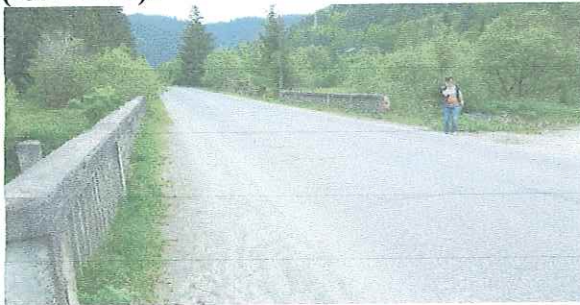
Foto nr. 1: Vedere generala. Podul este oblic, nu are trotuare si nici parapete de dirijare. Degradari ale parapetului existent din beton.
