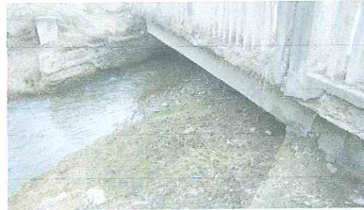
Foto nr.2: Vedere culee mal drept-aval. Degradari ale grinzii de parapet pe zidurile intoarse. Lucrarile de aparare de mal, neterminate. Vegetatie pe trotuar.
