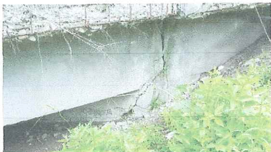
Foto nr. 5: Detaliu degradari. Grinda de parapet este distrusa, cu beton segregat si armatura la vedere. Fisura in coltul racordarii cu zidul intors.
