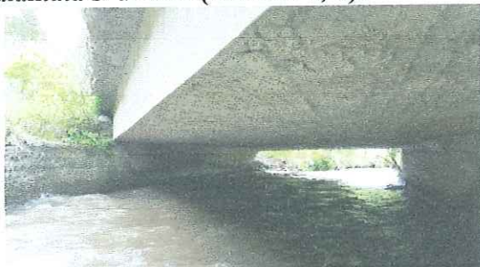
Foto nr. 3: Vedere intrados dala. Spatiu insuficient pentru inspectii si reparatii.
