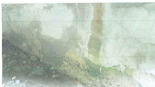
Foto nr. 7: Detaliu degradari la rostul elevatie-fundatie. Beton segregat, friabil. Tencuiala compromisa, umeda si faiantata.
