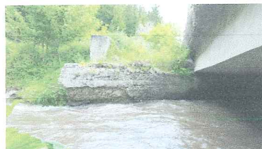
Foto nr. 8: Detaliu degradari la lucrarea dedirijare a apelor raului Olt. Betonul este segregat, cu lipsa de material, vegetatie pe coronament. Grinda de parapet degradata.
