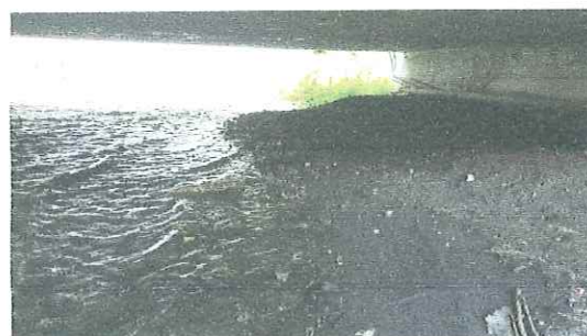
Foto nr.12: Vedere sub pod spre culeea mal stang. Depuneri de material solid. Degradari ale fetei vazute a culeei in zona mal stang aval.
