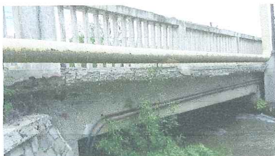
Foto nr.7: Vedere din amonte. Grinda de parapet degradata, cu armatura la vedere. Cablaje agatate de peretele exterior al dalei. Conducta de gaze care tranziteaza albia Oltului.
