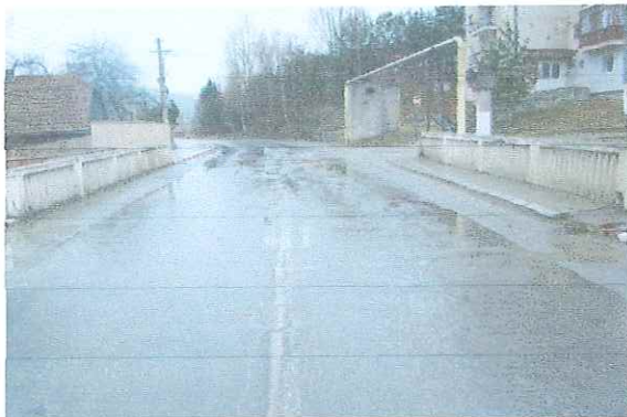
Foto nr. 1: Vedere generala: Podul pe directia Carta are un trotuar, iar pe directia spre Balan trotuarul este adiacent podului, fiind independent ca structura. Nu exista parapeti directionali
