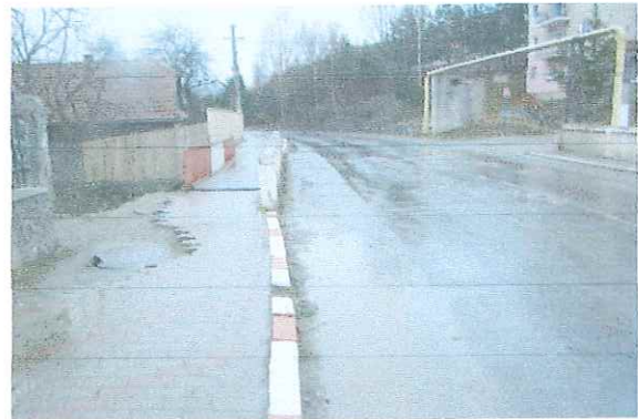
Foto nr. 2: Nealinieria parapetului existent cu bordura trotuarului drumului.
