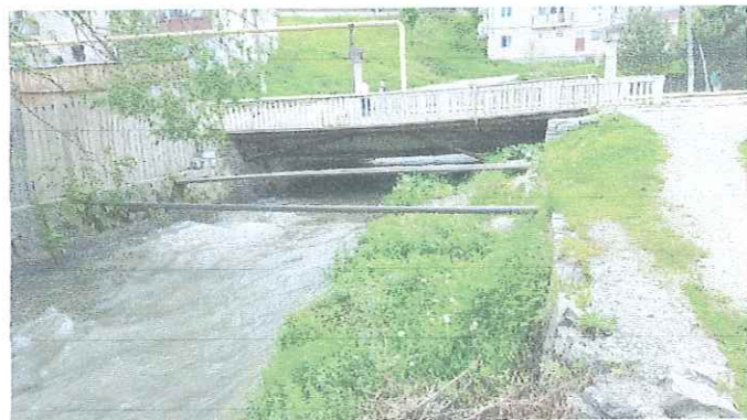
Foto nr. 4: Vedere din aval. Conducte care travesaza albia raului Olt. Malurile sant indiguite. Multa vegetatie in albia amenajata. Degradari ale digului mal stang.
