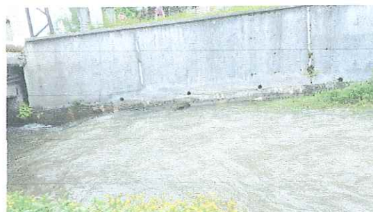
Foto nr.6: Vedere dig mal drept amonte. Degradari la rostul fundatie –elevatie al zidului. Urme de cofraj lasate in lucrare. Barbacane pentru scurgerea apelor de infiltratie din umplutura din spatele zidului.
