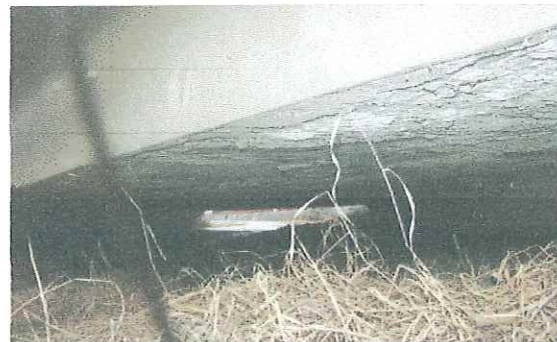
Foto nr. 6: Vedere intrados dala. Spatiu insuficient pentru vizitare si reparatii. Degradari ale intradosului dalei.
