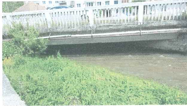
Foto nr. 2: Vedere din aval spre amonte. Conducte agatate de grinda de parapet. Degradari ale parapetului la mana curenta.
