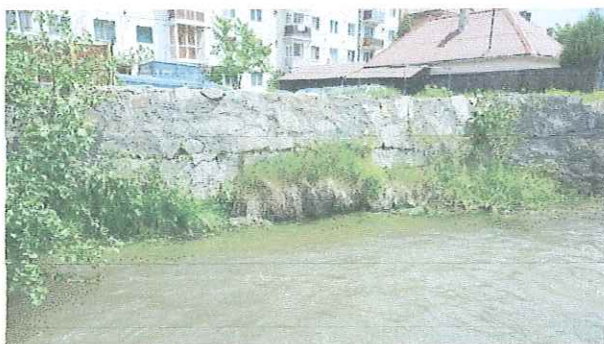
Foto nr. 7: Zidul de sprijin prezinta o fisura principala, probabil, pe linia rostului suprainaltarii. Vegetatie in albie, la baza zidului de sprijin.
