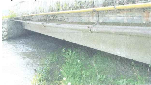
Foto nr. 4: Detaliu degradari ale grinzii de parapet. Beton exfoliat, cu pete de rugina si lipsa material. Vegetatie pe trotuar
