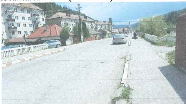
Foto nr. 1: Vedere spre centrul localitatii Balan. Parte carosabila degradata cu gropi si fagase.
