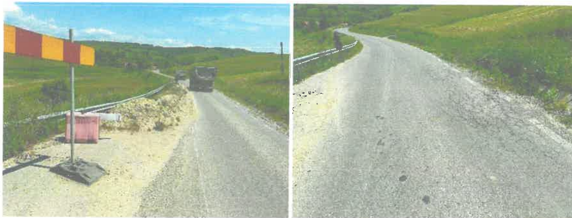
Fig.5 - Situația existentă a sectorului de drum la momentul vizitei în teren, pe fiecare zonă delimitată, funcție de problemele identificate - 2023
